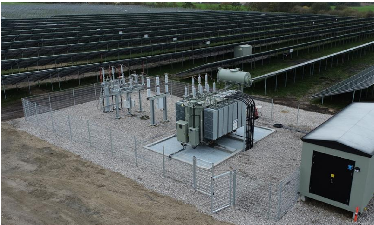
Kuva 5. Esimerkkikuva teollisen mittaluokan aurinkovoimalaitoksen muuntamoalueesta ja paneelientistä.
